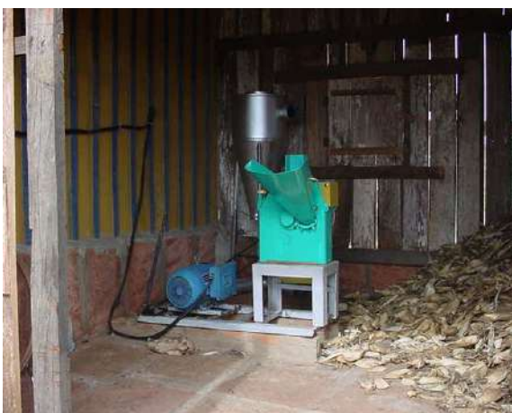
Figura 10.1 Equipamento novo que está sendo utilizado há um mês na pecuária de corte. Ribeirão Claro – PR, após a ligação pelo Programa Luz para Todos (29/06/05)
