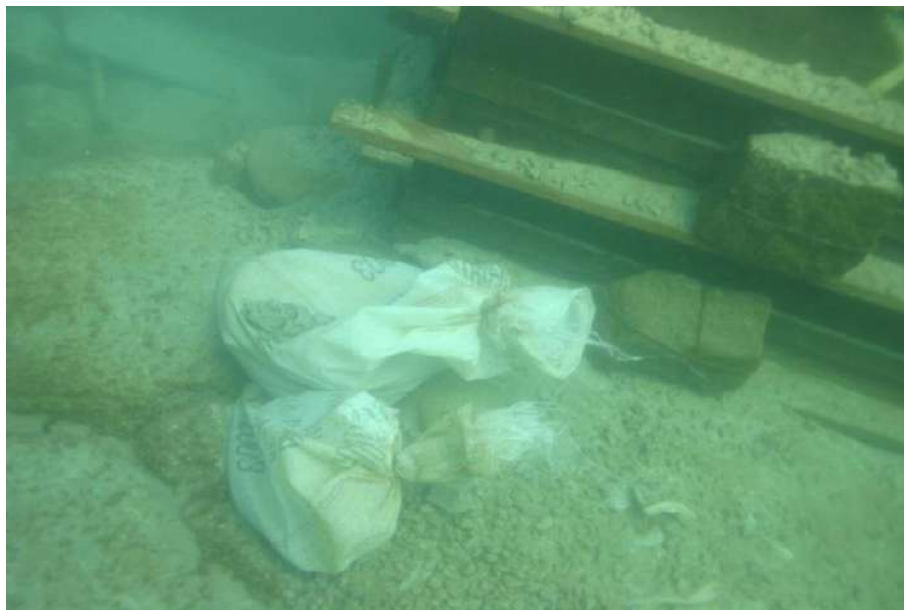
Figura 10.13 - Sacos de polipropileno com restos de materiais depositadas ao fundo do mar durante execução de obra submersa;
