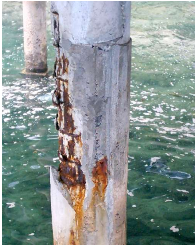
Figura 10.3 Armadura com alto grau de corrosão apesar de se verificar um cobrimento de armadura bastante espesso, mas provavelmente com alta porosidade.
