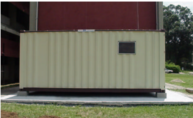
FIGURA 8 – CABINE DE MEDIÇÃO.
