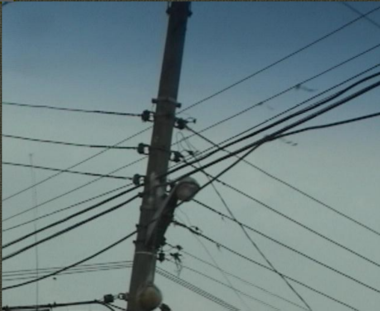
Luminária: braço compacto S.P., Capital.
