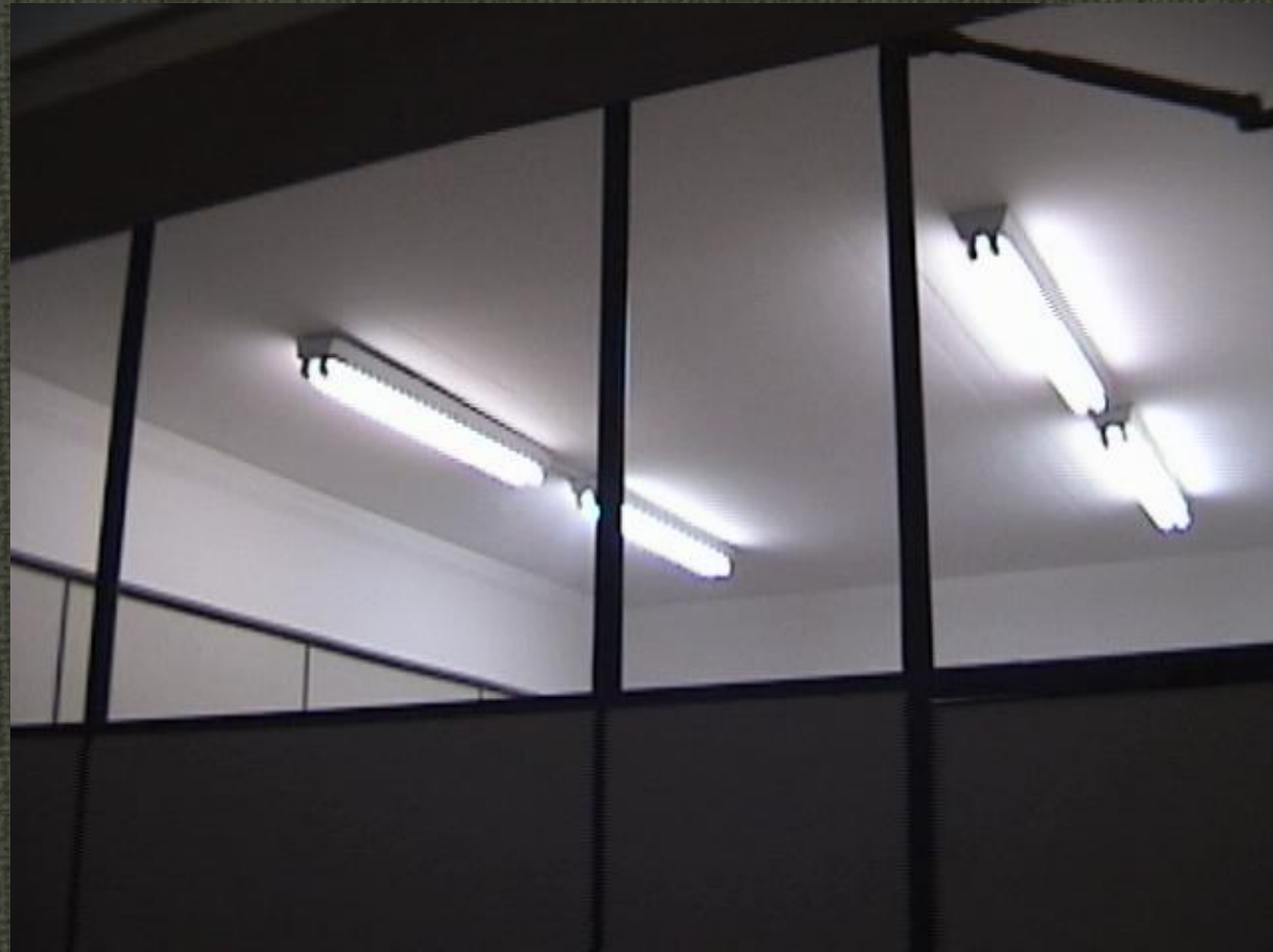
Figura – Sistema 40WT12, sem refletor e teto com pintura branca. Foto no IEE/USP, “prédio da administração”.
