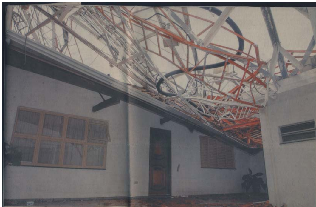
Figura 22 - Queda de torre em Campinas
