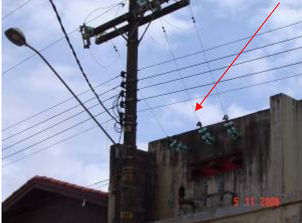
Figura 17: Foto de um ramal de serviço em alta tensão
