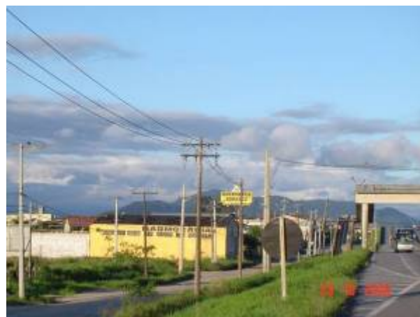
Figura 10: Foto de alimentadores radiais paralelos
