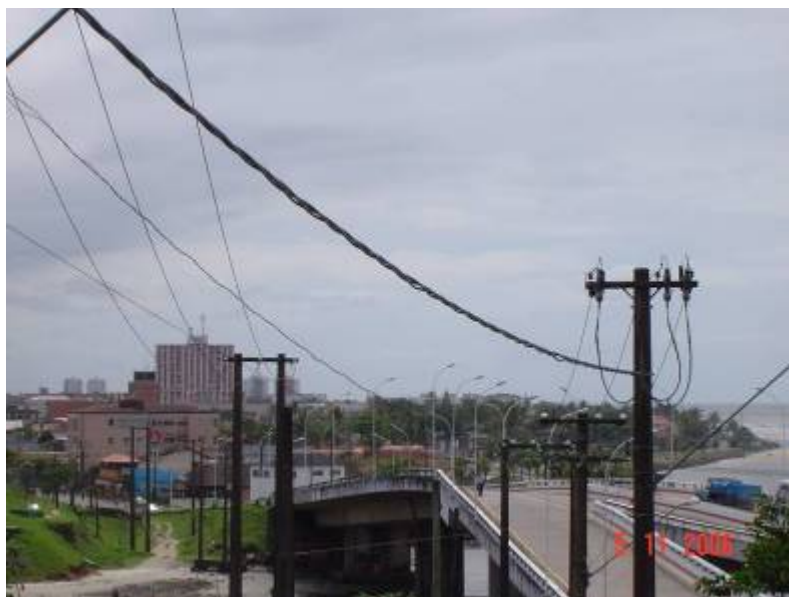
Figura 12: Foto de uma rede primária de distribuição com cabos pré-reunidos ou multiplexada
