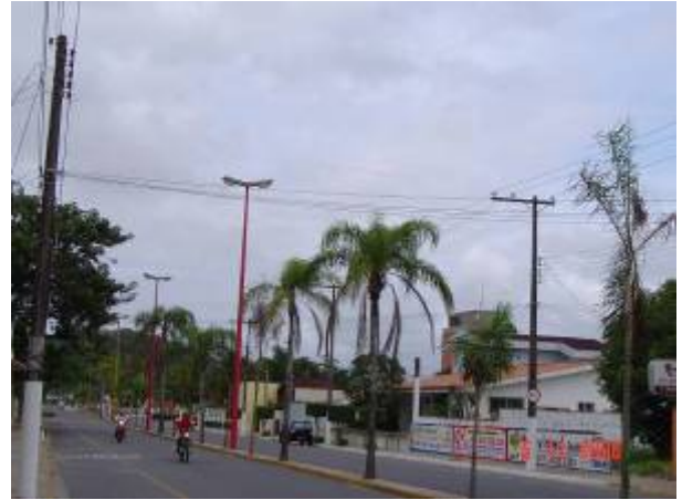
Figura 23: Foto de iluminação pública ornamental em canteiro central de avenidas, utilizando torres metálicas com luminárias em pétalas
