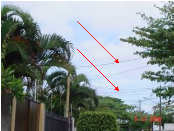
Figura 19: Foto de uma entrada de serviço de consumidor em baixa tensão em região arborizada
