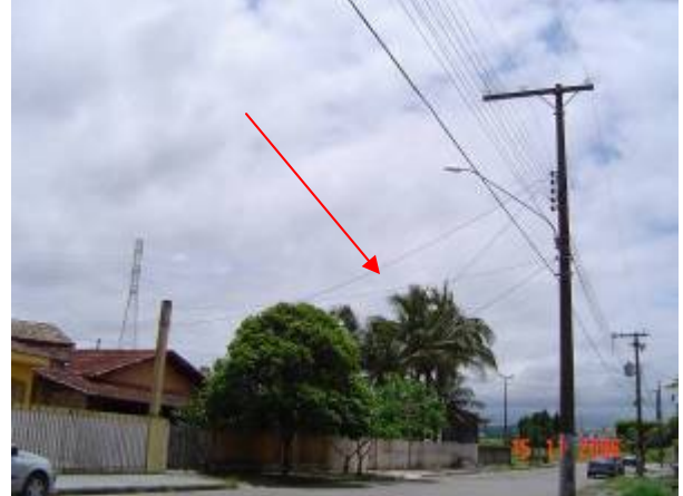
Figura 18: Foto de um ramal de serviço em baixa tensão
