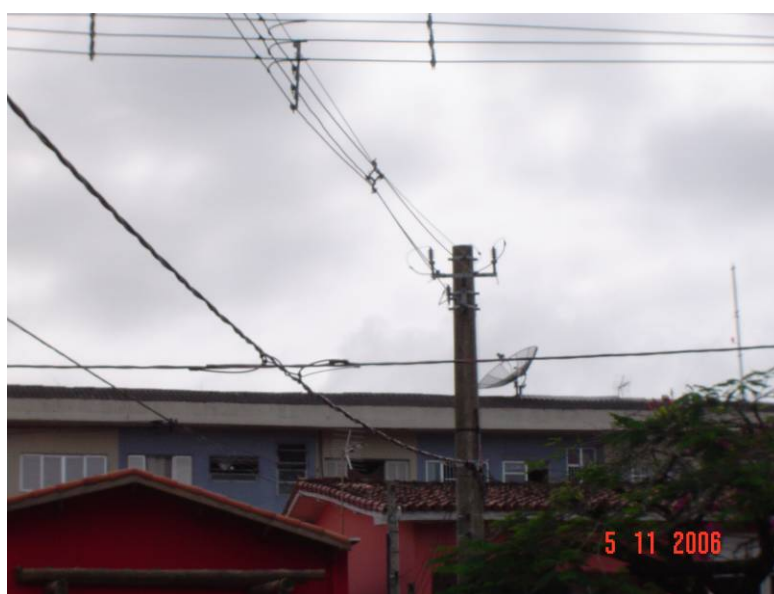
Figura 13: Foto de uma rede primária de distribuição compacta ou “spacer cable”
