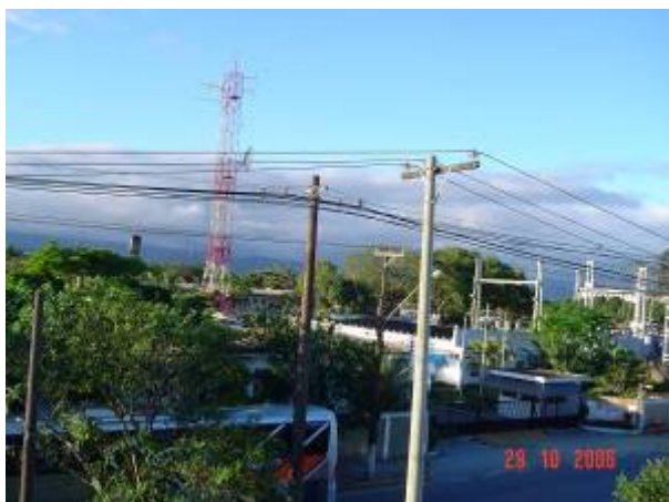
Figura 9: Foto de alimentadores na saída da subestação de distribuição com rede convencional e “spacer-cable” ou rede compacta, a qual ocupa espaço aéreo reduzido.
