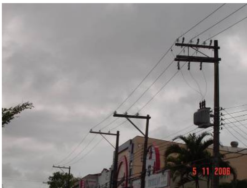
Figura 14: Foto de um transformador de distribuição, 13,8kV/ (220/127)V, em rede convencional.
