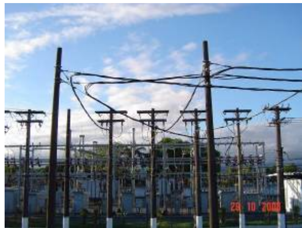
Figura 8: Foto de uma subestação de distribuição
