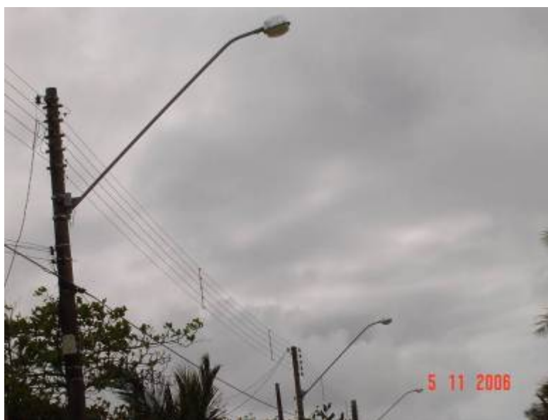
Figura 21: Foto de iluminação pública convencional com braço metálico, projetor em alumínio, protegido com refletor de vidro e relé fotoelétrico coletivo
