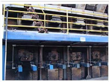
As caldeiras queimam o bagaço que chega pelas esteiras da usina
