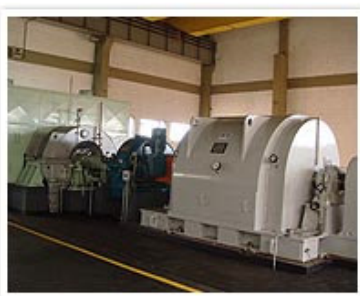
Turbinas recebem vapores da queima do bagaço de cana e geram energia
