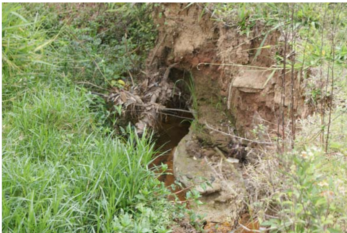
Erosão de margem do Córrego das Pedras.
