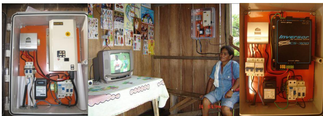
Figura 5 – Quadro elétrico instalado em Aiucá (esquerda e meio) e em Varadouro (direita). Foto: Arquivo gráfico do LSF-IEE-USP
