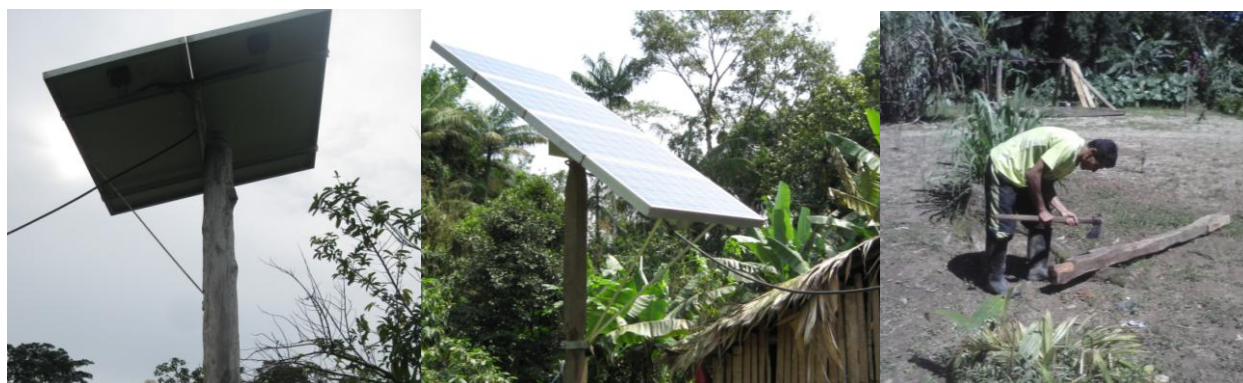
Figura 3 – Postes de madeira com suporte de alumínio (esquerda e meio) e processo de adequação do poste para o encaixe do suporte de alumínio.
