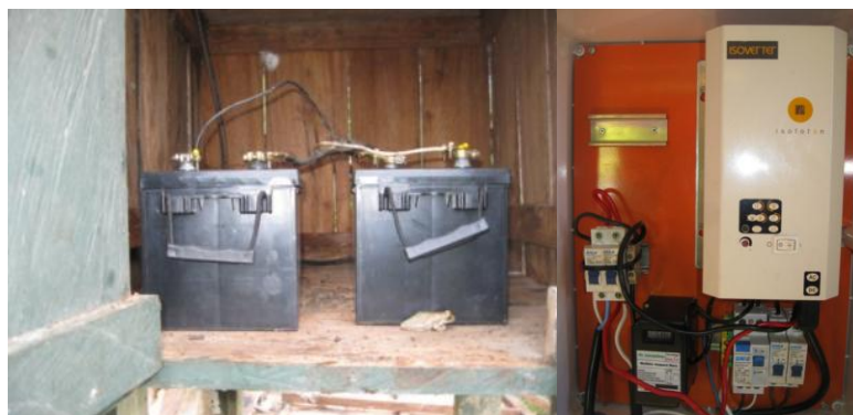
Figura 8 – Baterias substituídas (esquerda) e quadro elétrico sem controlador (direita).
