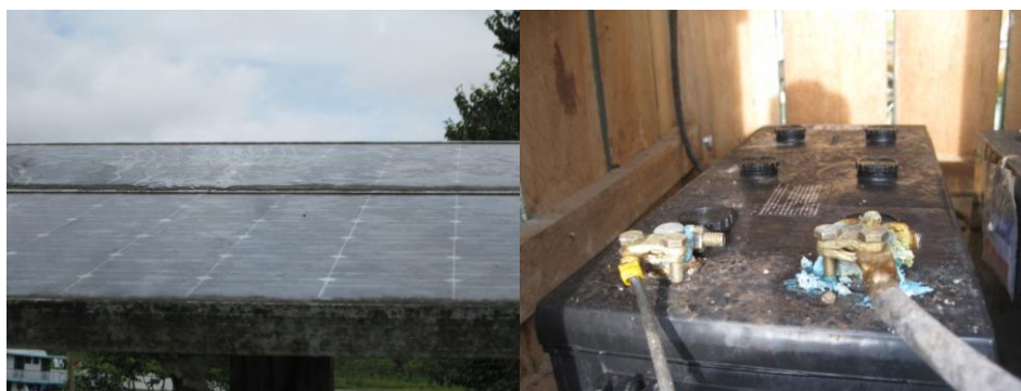
Figura 7 – Problemas com a manutenção dos componentes dos SFDs.
