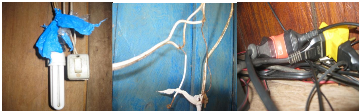
Figura 6 – Problemas com a fiação interna.
