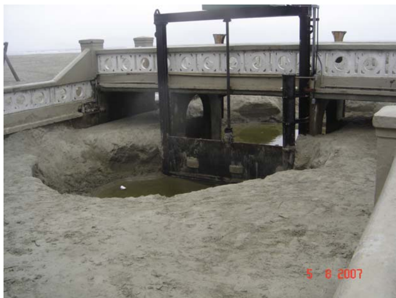
Canal 3 soterrado devido ao excesso de areia depositada nos dois lados da comporta.
